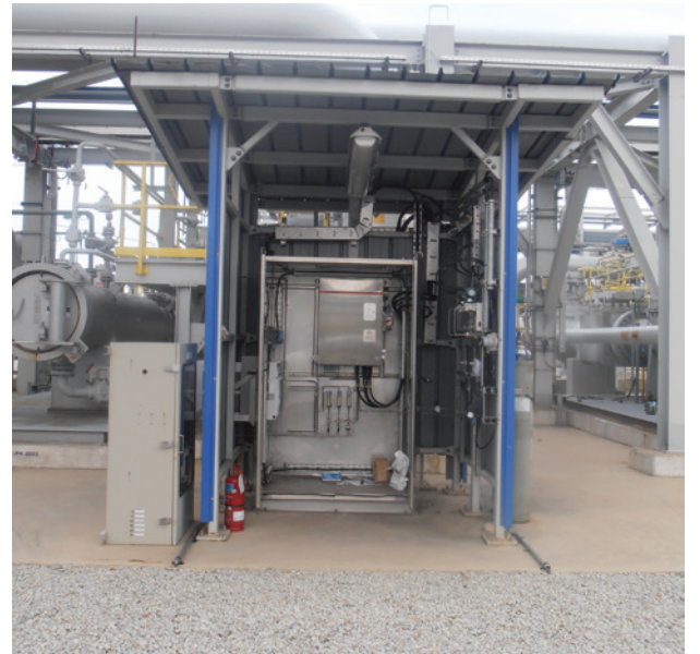
LNG Terminal application
