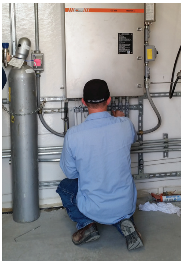
Medor ex CSA – Odorization site in USA
